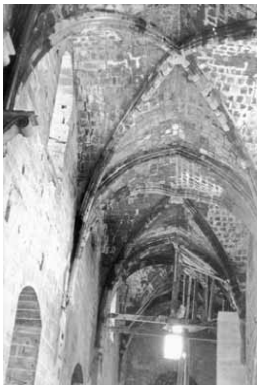
2. Άποψη του ανατολικού τμήματος του μέσου κλίτους του ναού της Παναγίας Οδηγήτριας. (φωτ. Τμήμα Αρχαιοτήτων).
