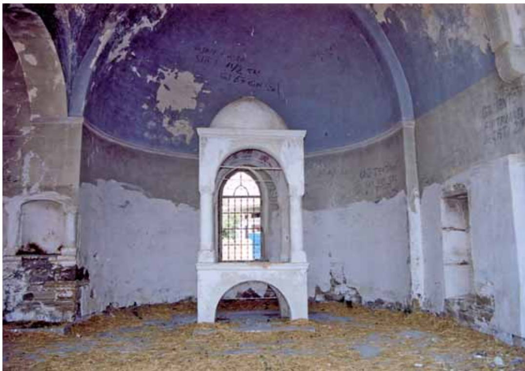
1. Το εσωτερικό του νοτίου κλίτους μετά την λεηλασία και την καταστροφή. (Αρχείο Ι. Συνόδου).
