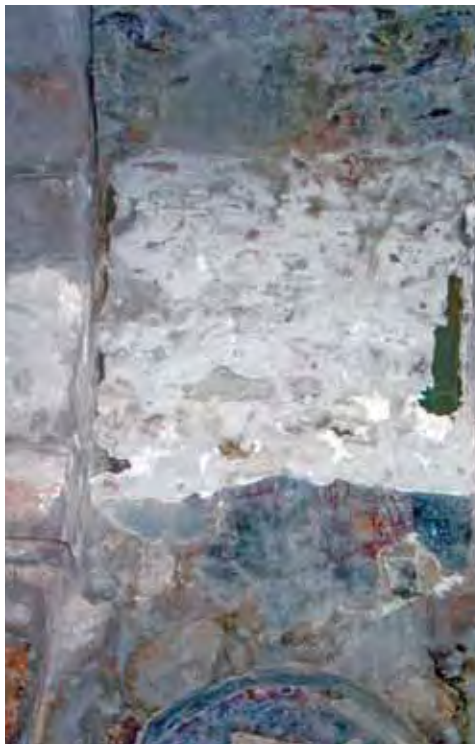
1. Υπολείμματα των τοιχογραφιών του Αγίου Ιωάννου του Χρυσοστόμου και του Αγίου Γεωργίου μετά την αφαίρεση των άνω τμημάτων των δυό τοιχογραφιών. (φωτ. Τμήμα Αρχαιοτήτων).
